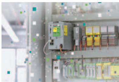
Il controllore PLCnext Control RFC 4072S di Phoenix Contact utilizza l'attuale profilo Profisafe 2.61
