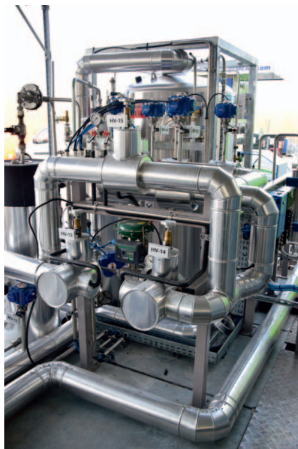
Dettaglio del microimpianto di liquefazione LNG
