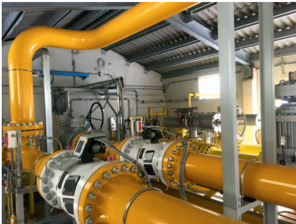
Installazione finale con la strumentazione Sick, che consente una misura fiscale senza interruzione anche in caso di black out
