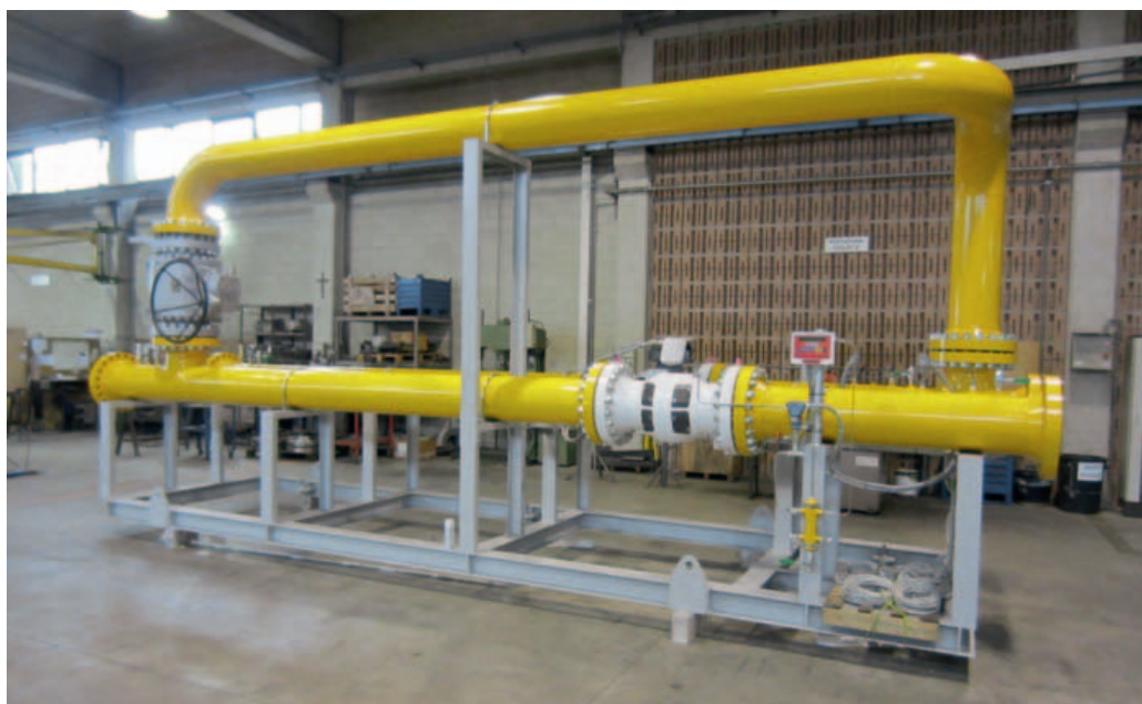
Skid di Misura a due linee da 12 pollici CL600 con bypass in fase di assemblaggio e collaudo in officina
