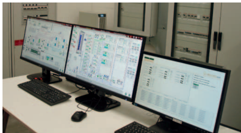
Sala di controllo dell'impianto
