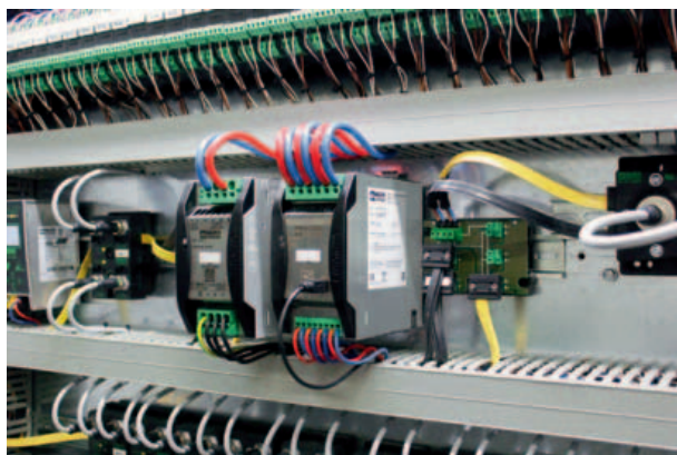
Il sistema Emparro AccuControl di Murrelektronik installato in un armadio elettrico
