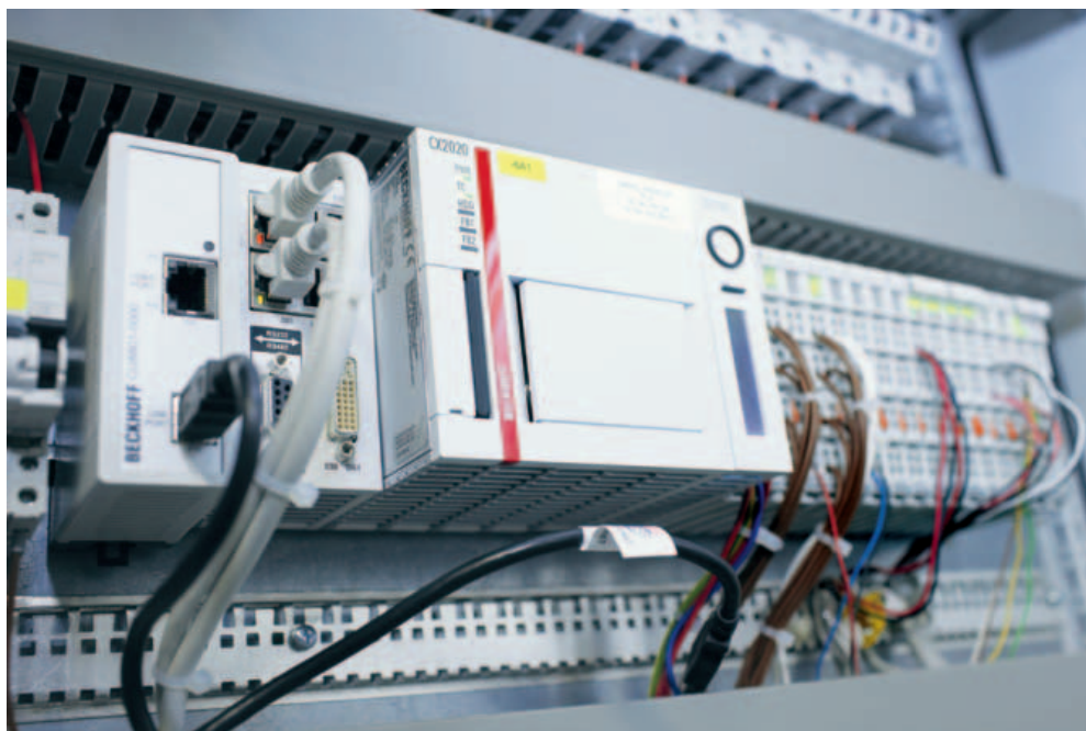
Figura 3 - Il PLC CX2020 che funge anche da server locale del sistema di monitoraggio Filippetti
