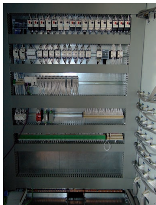
Vista interna del quadro di comando per la macchina
