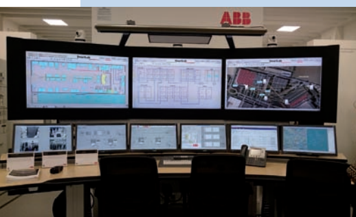
La sala controllo dello Smart Lab di Dalmine
