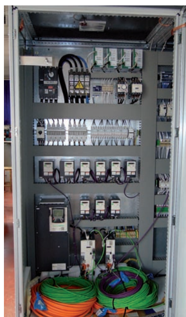
I cablaggi e l'interno del quadro di comando per la macchina
