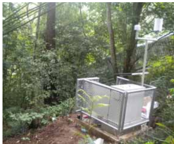
In Thailandia Sisgeo ha realizzato un sistema con 10 router per monitoraggio di aree franose
